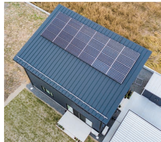
S様邸 太陽光発電システム
