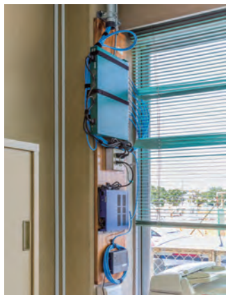
職員室に設置されているセンター。拠点ルーターと基幹スイッチが設置されており、ここを拠点に各階の校内の各廊下のスイッチングハブまで有線をつなげています。
