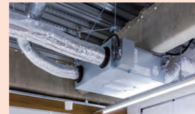
熱交換ユニット
