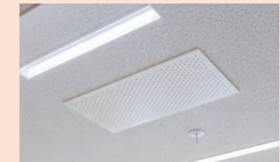
天井輻射空調
