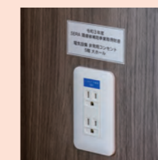
太陽光発電システムと連携し、災害時に使用できるコンセント
