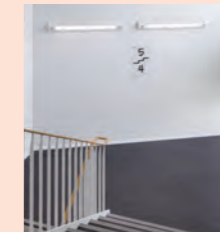
階段通路誘導灯
