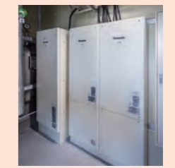
蓄電システム(パワーステーション)
