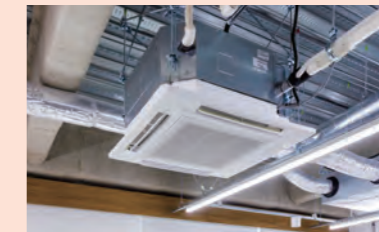
エアコン室内機
