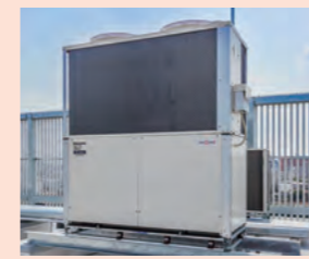
ガスヒートポンプエアコン室外機
