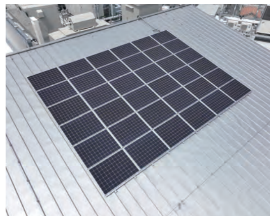
屋根に設置されている太陽光発電パネル
