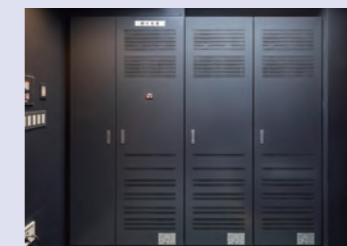
調光装置の入った分電盤。舞台照明は既設のハロゲン照明を残し、客席照明をLED化。将来すべてLED化したときにも対応できるようになっています。
