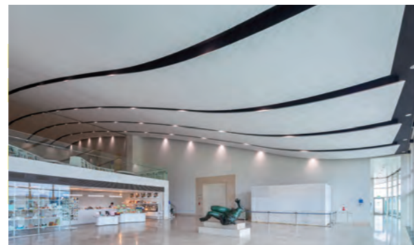
天井の耐震化工事では、アルミ製からガラスファイバー製に軽量化。改修前と意匠が極力変わらないよう製作。西側は全面ガラスで宍道湖が臨める。LED照明はマルチマネージャExで調光調色されています。
