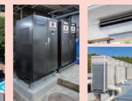
リチウムイオン蓄電システム 119kWh
