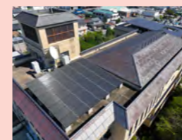
太陽光発電システム 71kW
