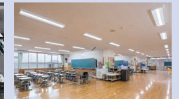
LED照明器具(教室)
