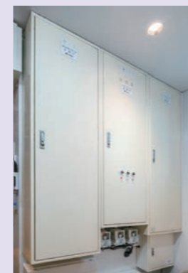
エネマージ壁掛けパネル(組込盤)
