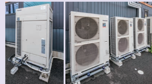
パッケージエアコン室外機(店内用)
