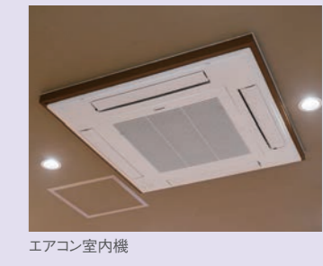
エアコン室内機
