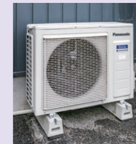
ルームエアコン室外機(事務所用)
