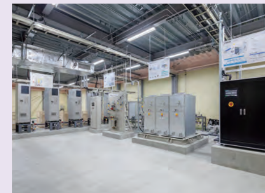
水素棟内に設置されている水素発電設備 (左側がパナソニックの純水素型燃料電池)
