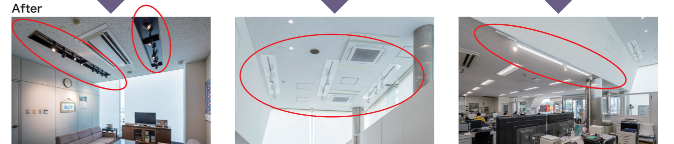
イージーアップ配線ダクト +TOLSO BeAm Free スポットライト
