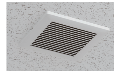
熱交換気システム
