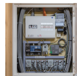
エネルギー管理システム
