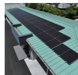
太陽光発電システム
