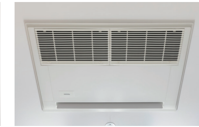
パッケージエアコン室内機
