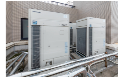
パッケージエアコン室外機
