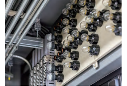
ケーブルラック配線と盤内接続実習設備の確認表示灯
