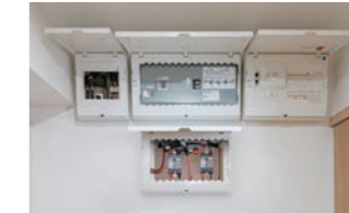
上段左から: 電力検出ユニット、電力切替ユニット、スマートコスモ、下段: 漏電ブレーカ
