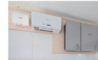
左から: 接続箱、パワーコンディショナ、蓄電池用コンバータ、パワーステーション
