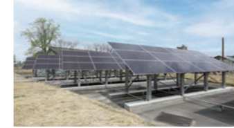
太陽光発電システム
