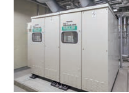
吸収冷温水機
