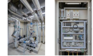
空調ポンプ設備 エマネージ
