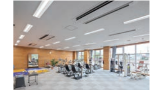
LEDベースライト・空調室内機
