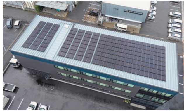
太陽光発電システム
