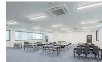
LEDベースライト・パッケージエアコン室内機
