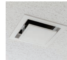
熱交換気システム
