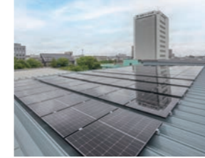
太陽光発電システム
