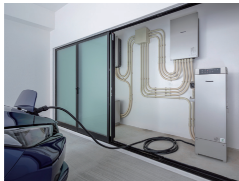
エネプラット V2H蓄電システムeneplatのV2HスタンドからEVへ充電中の様子。海に近い立地のため、重耐塩仕様をご採用。
