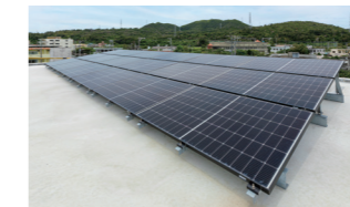
屋根に設置されている太陽電池モジュール。太陽光発電で創った電気を蓄電池へ貯めると同時にV2HスタンドからEVに直接充電可能。
