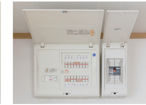
左:分電盤 右:電力検出ユニット
