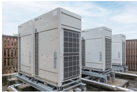
ZEB対応EHP (パッケージエアコン室外機)
