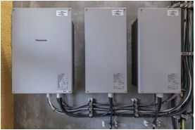
パワーステーション・コンバータ
