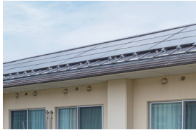
太陽光発電システム
