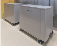
リチウムイオン蓄電池
