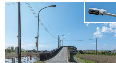
郊外：道路灯（遮光板使用）
