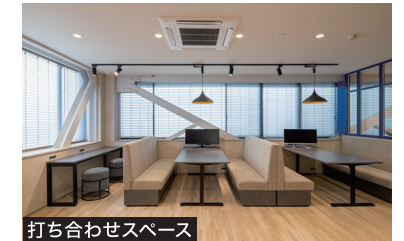
打ち合わせスペース リベコムON/OFFインターフェース+LEDペンダント・リベコム専用LEDスポットライト・LEDダウンライト・スケジューラー
