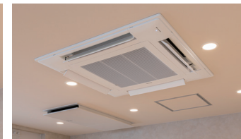
パッケージエアコン室内機
