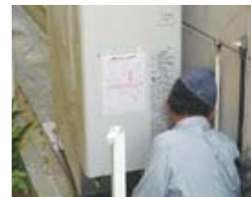
オール電化に必要なエコキュートを設置
