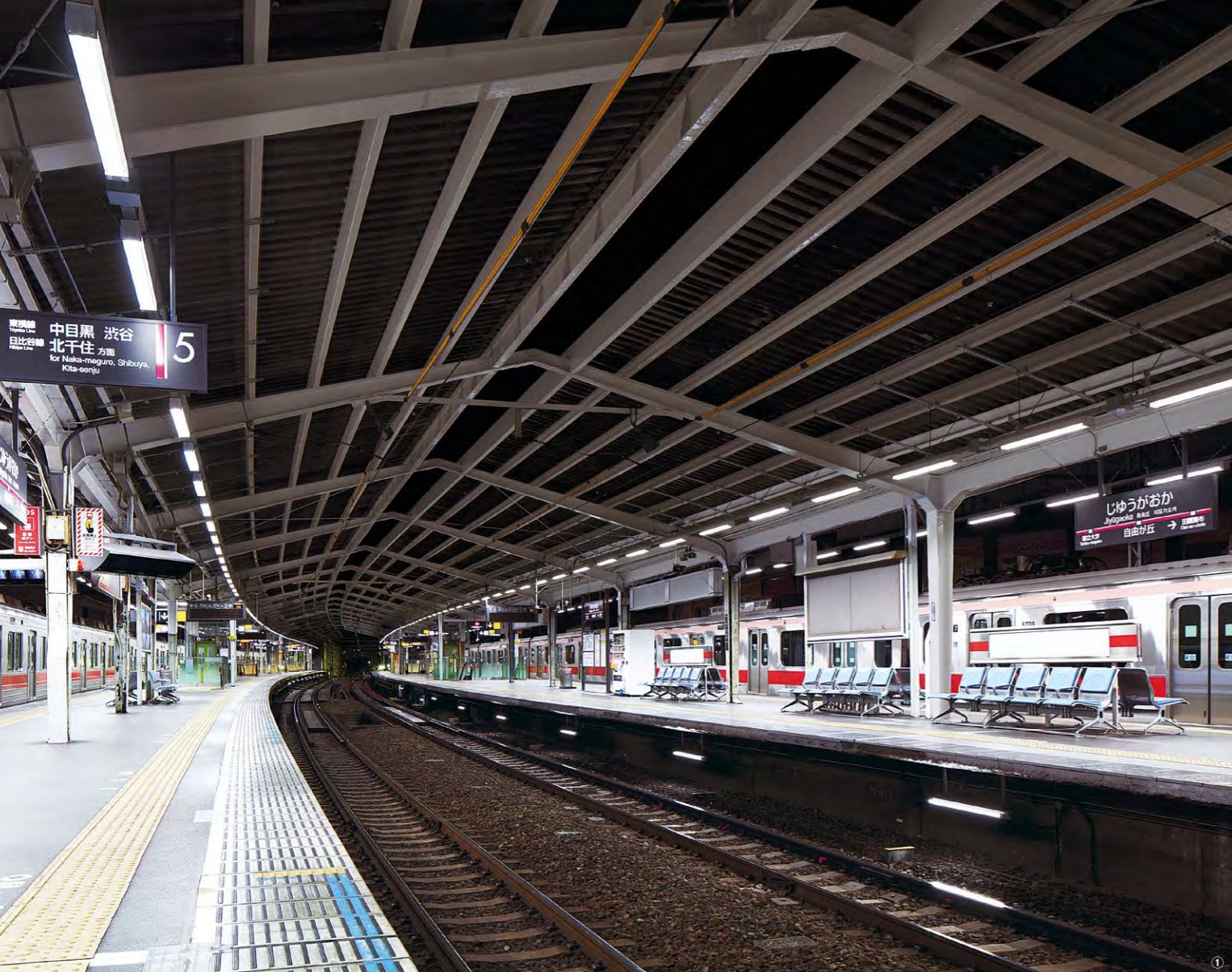
①東横線のLEDホーム照明
