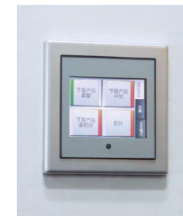
11階執務室のフル2線式リモコン タッチパネル式スイッチ
