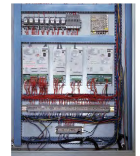
空調制御システム「Airopty」盤
