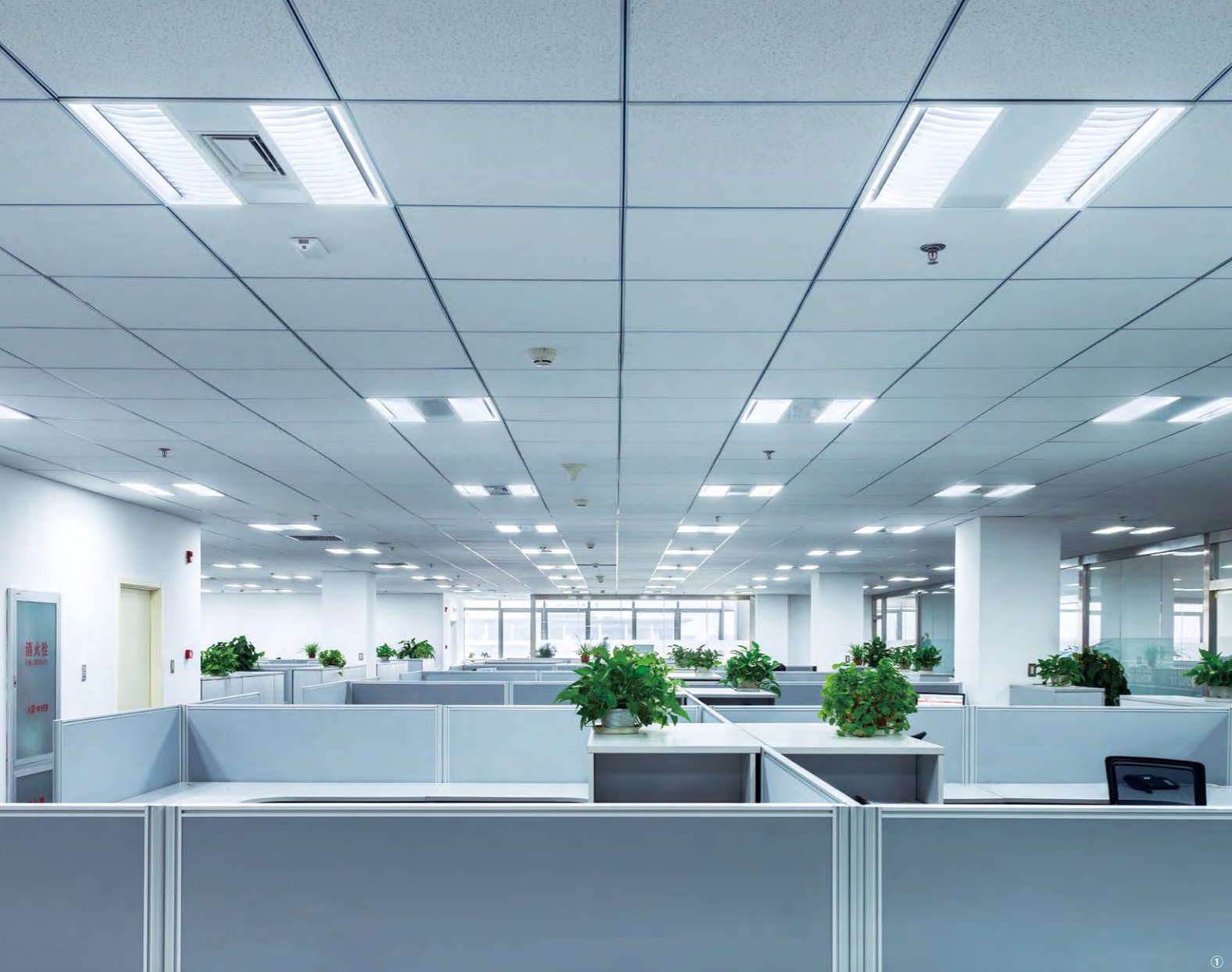
①16W2灯用e-Hf蛍光灯システム天井用照明器具が設置された執務室
