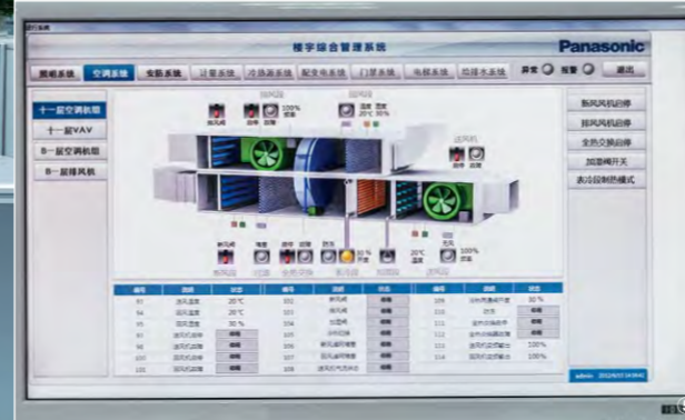
②防災センターの中央監視卓 ③防災センターに設置されているiopenet盤 ④エリアごとに空調制御を統合するICONT ⑤空調制御システムの管理画面
