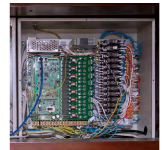
客室内に設置された Green Room コントローラ
