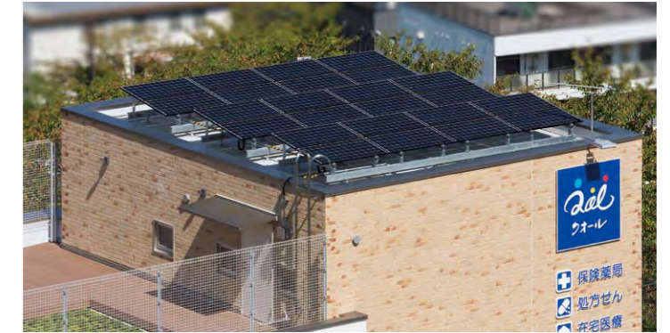
屋上に設置された太陽電池モジュール「HIT233」
