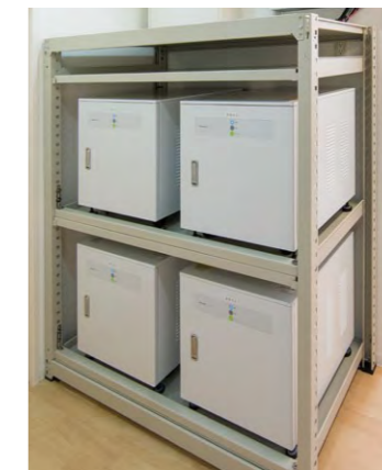
停電時に電子薬歴システムやネットワーク機器を約8時間稼働させるリチウムイオン蓄電池
