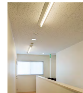
バックヤードに設置された直管LED照明器具
