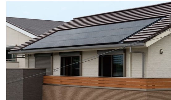
屋根に設置された15枚の太陽電池モジュール「HIT233」は、総出力3.495kW
