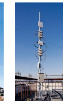
市庁舎内に設置されたアンテナ
