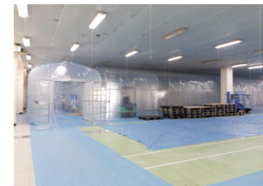
コストを追求してビニールハウスで造られた包装、出荷工程用クリーンルーム
