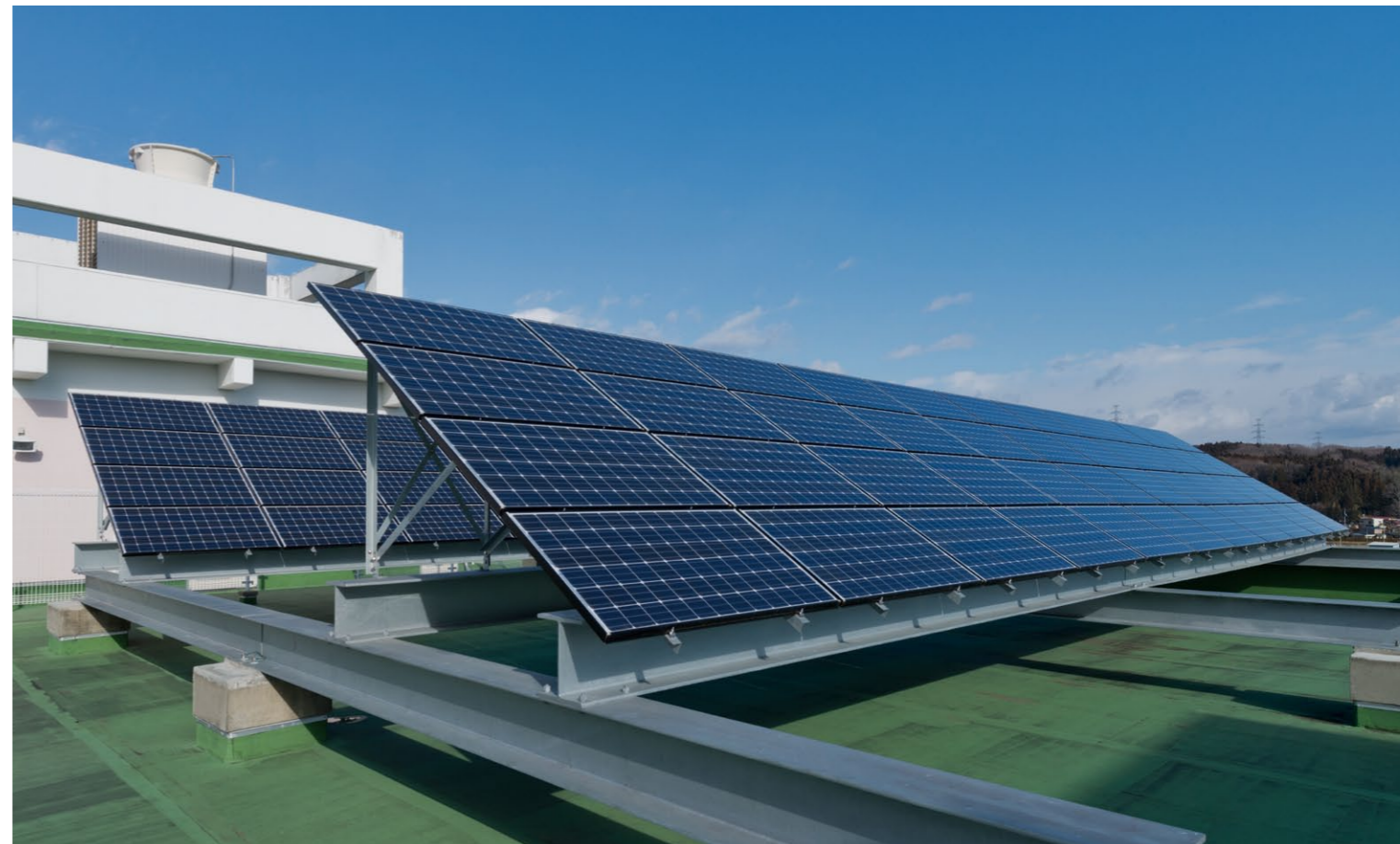
町民医療福祉センターの屋上に設置された20kWの太陽電池モジュールHIT233
