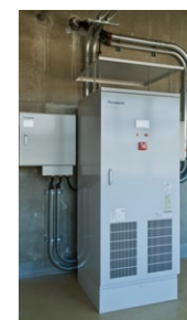
15kWhリチウムイオン蓄電池
