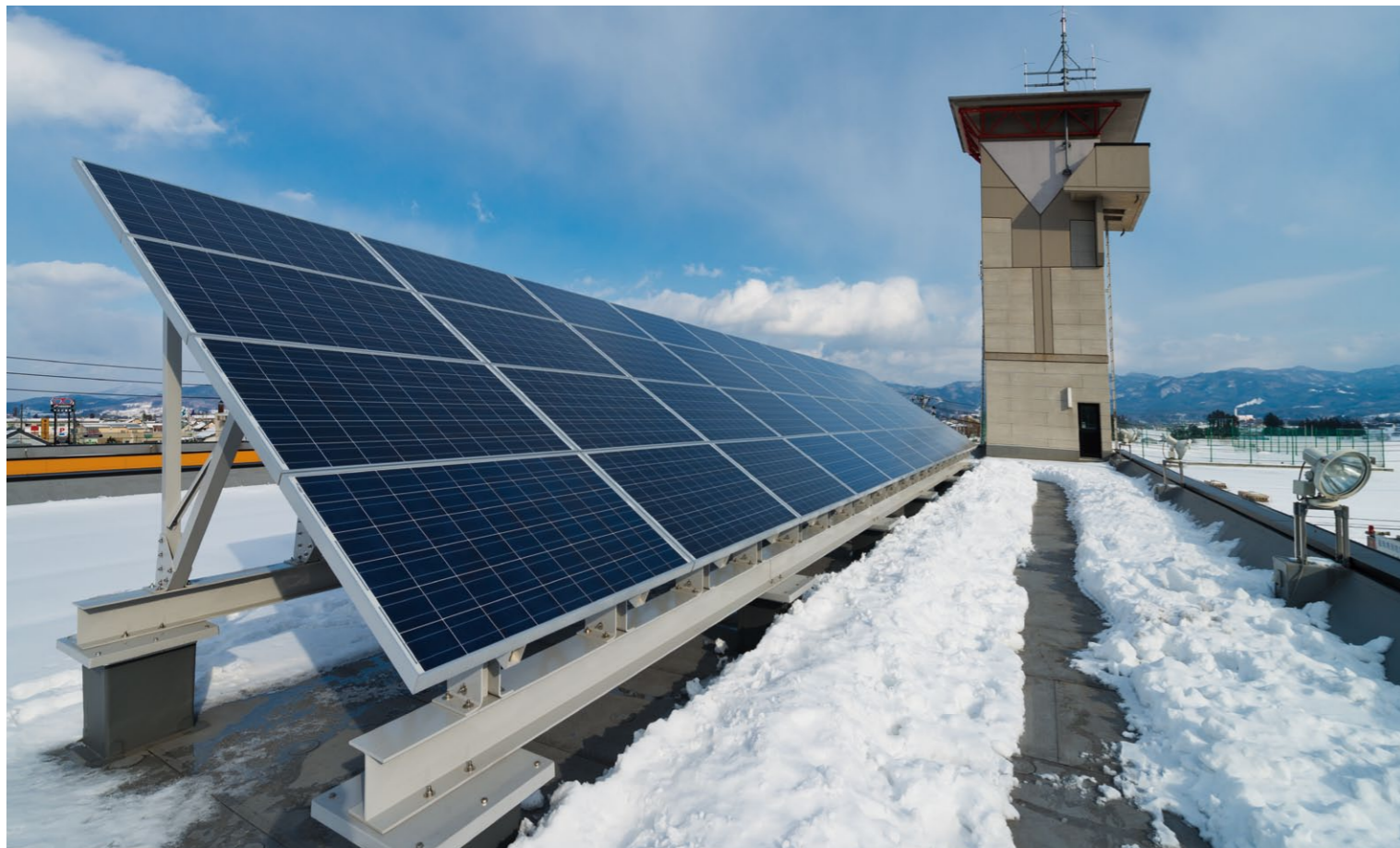
防災コミュニケーションセンターの屋上に設置された10kWの太陽電池モジュールHIT233
