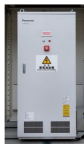
15kWhリチウムイオン蓄電池
