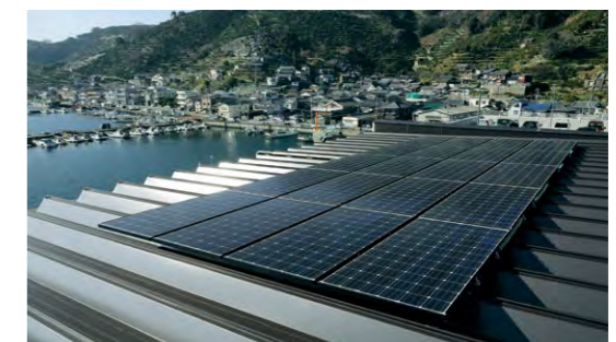
エレベーターホールの屋根に設置された太陽電池モジュール(4.8kW) 停電時にはPCや携帯電話の充電にあてる緊急電源として計画されている
