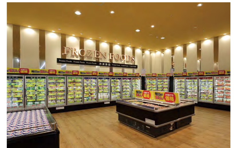
壁面に設置されたノンフロン冷凍リーチインショーケース
