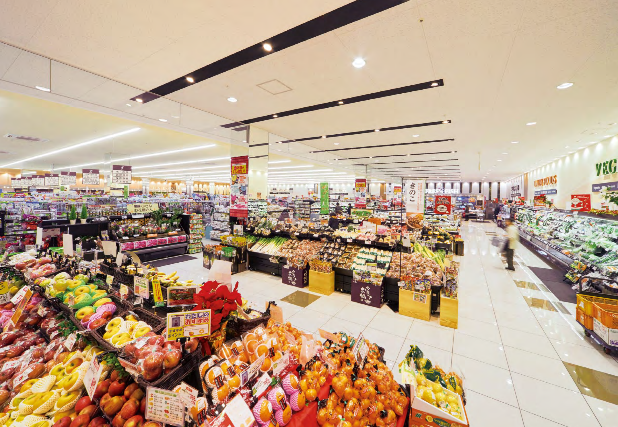
店舗中央はLEDベースライトiDシリーズをライン状に設置。平台はパワーのある250型ユニバーサルダウンライトで照射。壁面には150型ダウンライトを配置して明るさ感を確保。巡りやすい店舗動線を実現している
