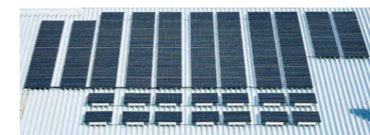
屋上に設置された太陽電池モジュール HIT238A (22.4kW)
