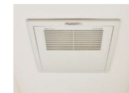
熱気調システムの屋内側空気取入口
