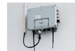
競技場壁面に設置されたマルチアクセスコンセントレータ
