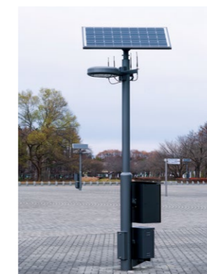
ソーラー街路灯の送信機(上)と蓄電ユニット(下)
