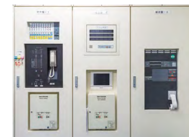
NIFREL防災センターの中央監視設備(左上)、防災システム(右)
