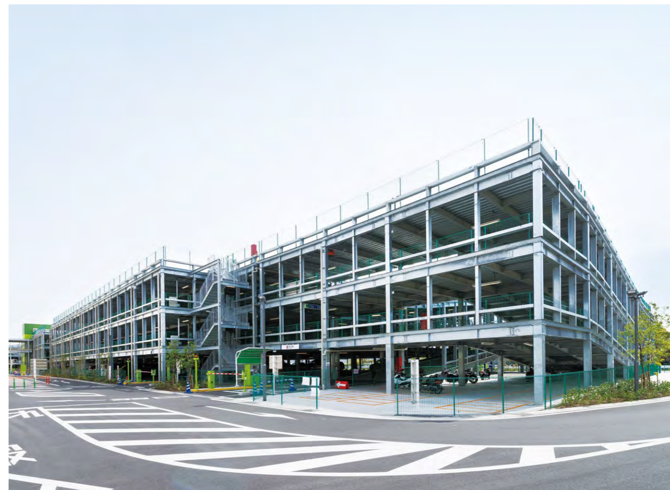
約4,100台の収容能力を有する自走式立体駐車場の1~3階に設置されたLEDベースライト iDシリーズ
