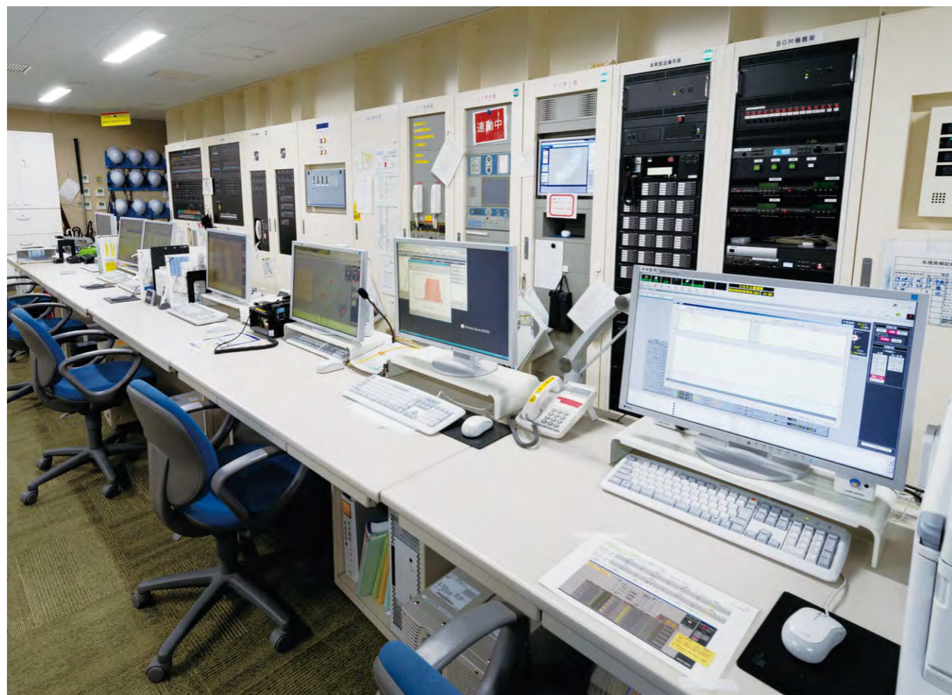
ららぽーとEXPOCITYの防災センターに設置された監視卓。右端は中央監視装置
