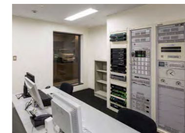
防災センターの自動火災報知設備と非常放送設備
