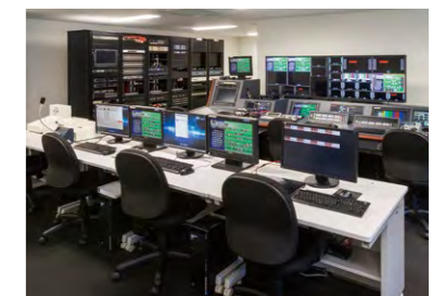
大型ビジョンからサイネージまで館内に映像を 送出する設備は避難誘導システムとも連携
