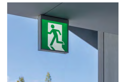
火災発生時には館内各所の避難誘導灯が 点滅して安全な避難を促す
