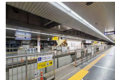
直管LEDを連結し23°傾けたプラットフォーム照明
