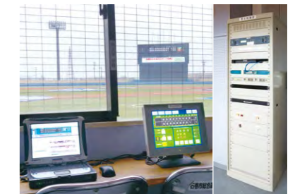
市民球場の操作卓と制御盤
