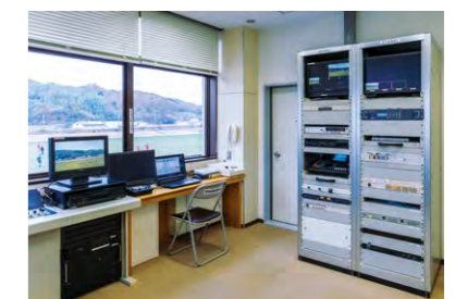
フットボール場の操作卓と制御盤
