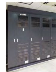
バックヤードに設置された調光盤
