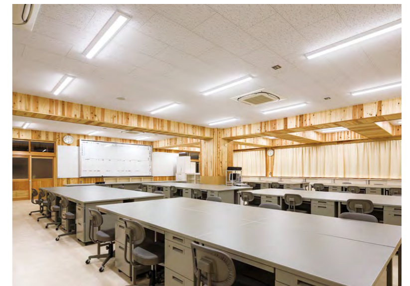
防災拠点となる職員室では、太陽光発電と蓄電システムの連携により長期間のDCP機能を維持する
