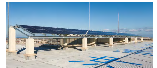
蓄電システムと連携した太陽電池モジュール (20.88kW)
