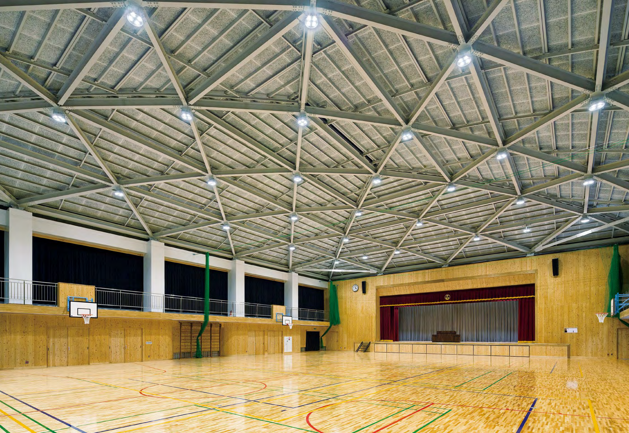
避難所としても想定された体育館には高天井LED照明器具が設置され、停電時には蓄電池により中央列の照明が点灯する
