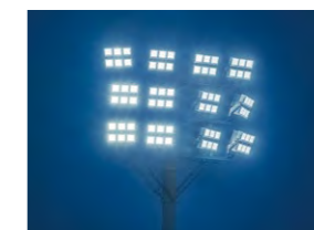
高さ14.8mのポールに取り付けられた モジュールタイプ投光器
