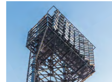
約39mの鉄塔に配置されたLED投光器
