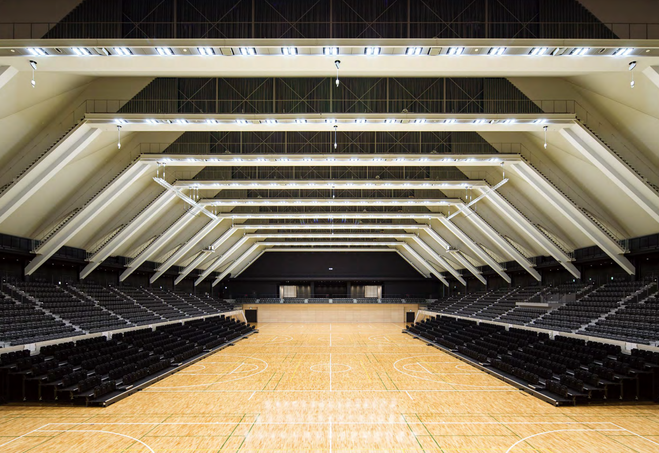
3600m 2 のメインアリーナではキャットウォーク下にLED高天井用照明器具を配置し、点滅回路を細分化することにより用途に応じた照度の調整が可能となっている
