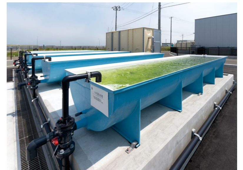
海水を用いた海藻の基礎研究プラント
