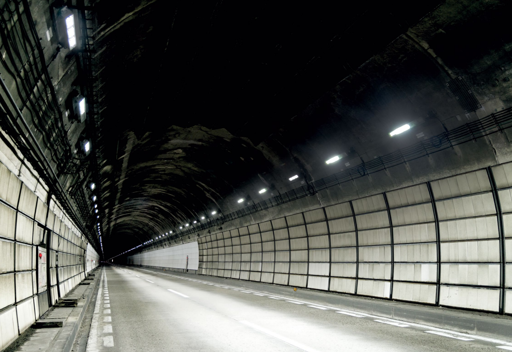
基本照明に加えて入口照明を100%点灯した状態。トンネル進入時に目が暗さに順応することを助ける
