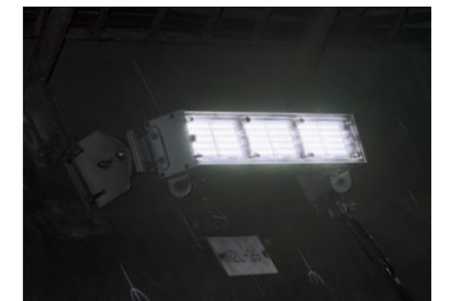
トンネルのベースとなる明るさを確保する基本照明
