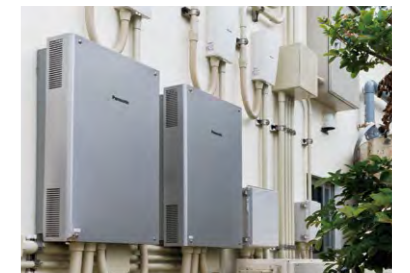
管理棟のパワーステーションS
