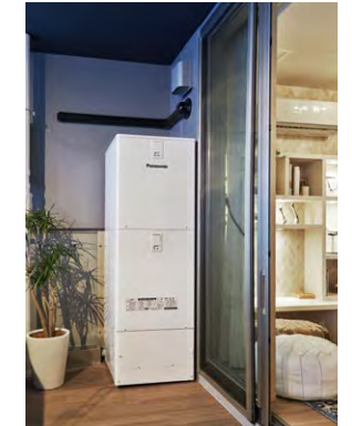
AEMSにより各住戸のHEMSを経て遠隔制御されるエコキュート
