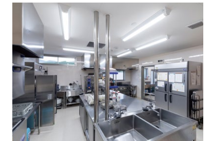
白色のiDシリーズが設置された給食室
