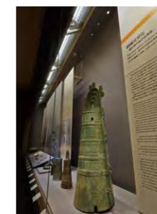
展示ケース上部に設置された直管LED2灯用器具
