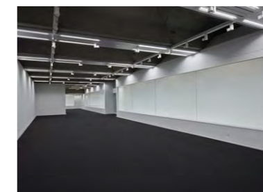
作業灯には建築構造と一体化するシームレス照明を採用
