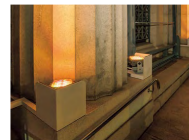
柱元に設置されたライトアップ用投光器
